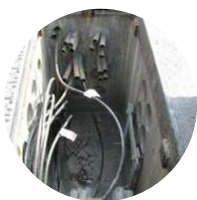
解決雨水 下水道纜線附掛
